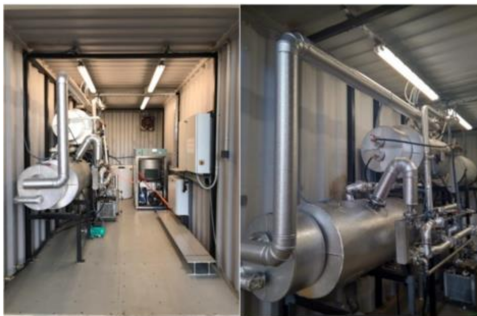
Figure 6. Photos of the MED evaporator
